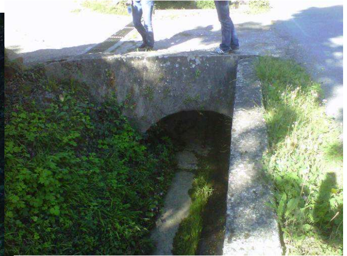
Ouvrage hydraulique à recalibrer
