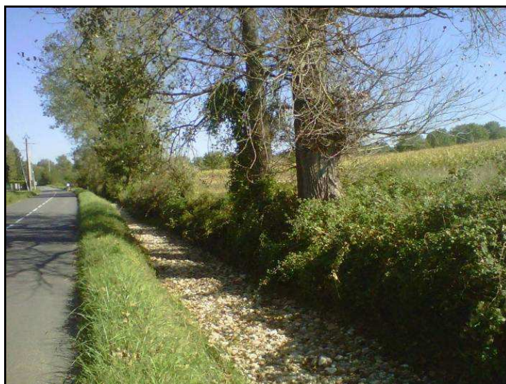
Aval du bassin versant – lit comblé par les sédiments
